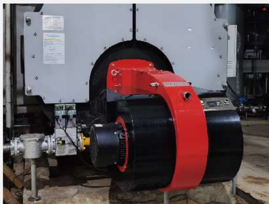
北京兆丰家园 2台4.2MW 热水锅炉 一体式内循环低氮燃烧器 30 mg/m 3
