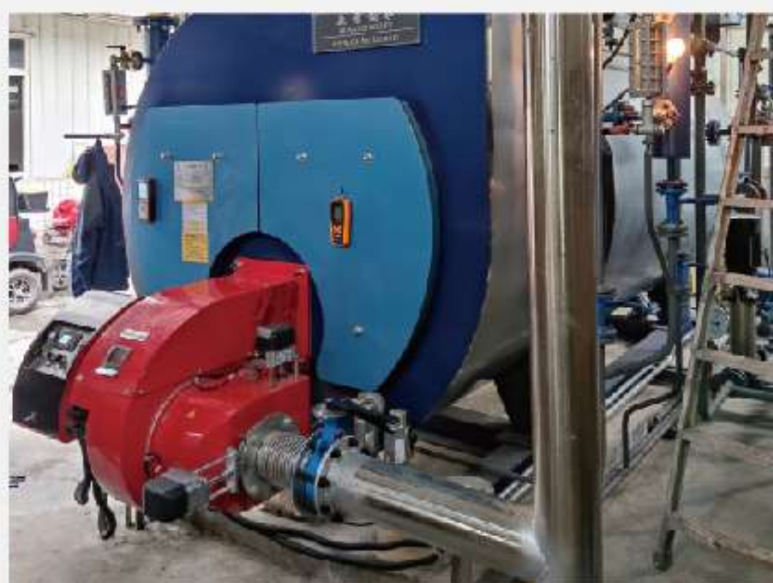
重庆 4吨蒸汽锅炉 一体式烟气外循环 低氮燃烧器 30 mg/m 3
