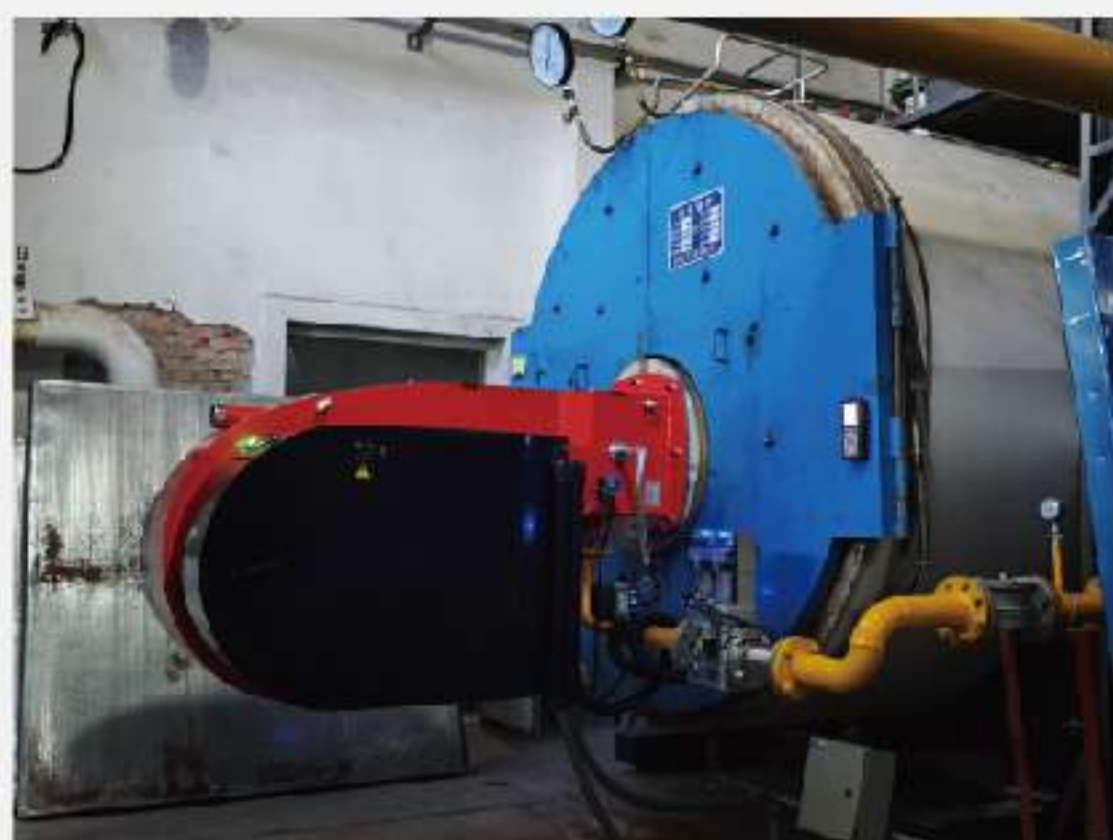
北京珠江中骏小区锅炉房 8吨 热水锅炉 一体式内循环燃烧器 30 mg/m 3
