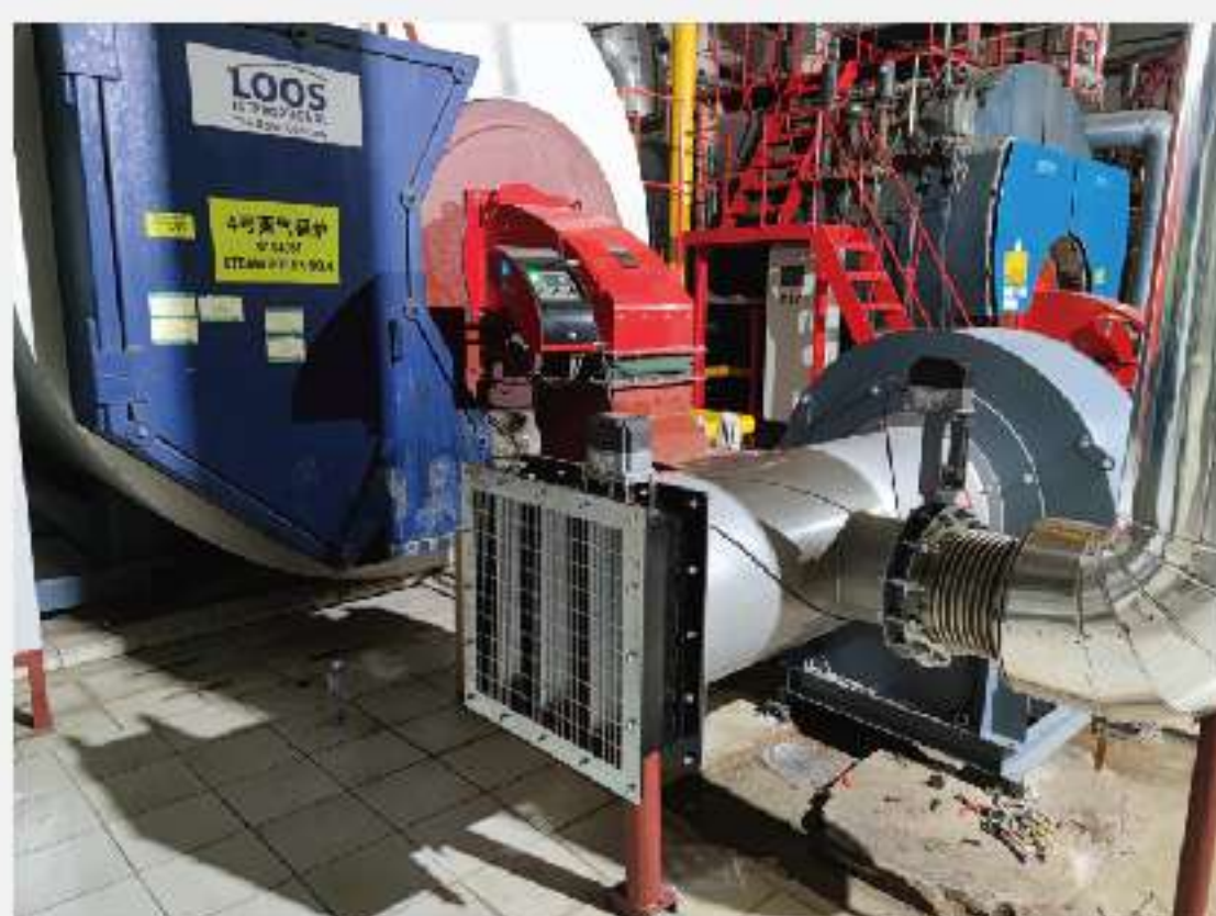
东莞生力啤酒 15 吨蒸汽锅炉 分体式烟气外循环低氮燃烧器 30 mg/m 3
