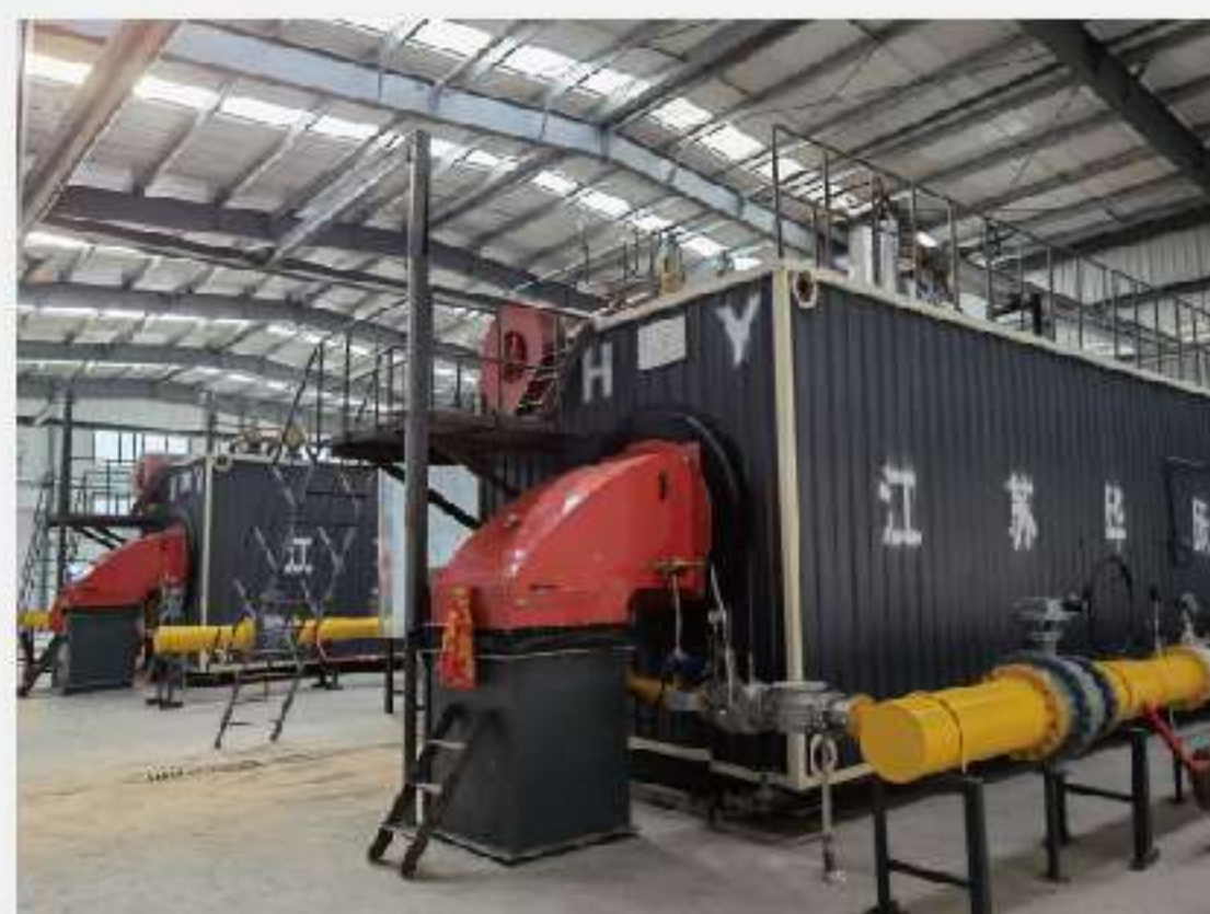
兰州永登县城南供热站 40吨热水锅炉 分体式内循环燃烧器 30 mg/m 3
