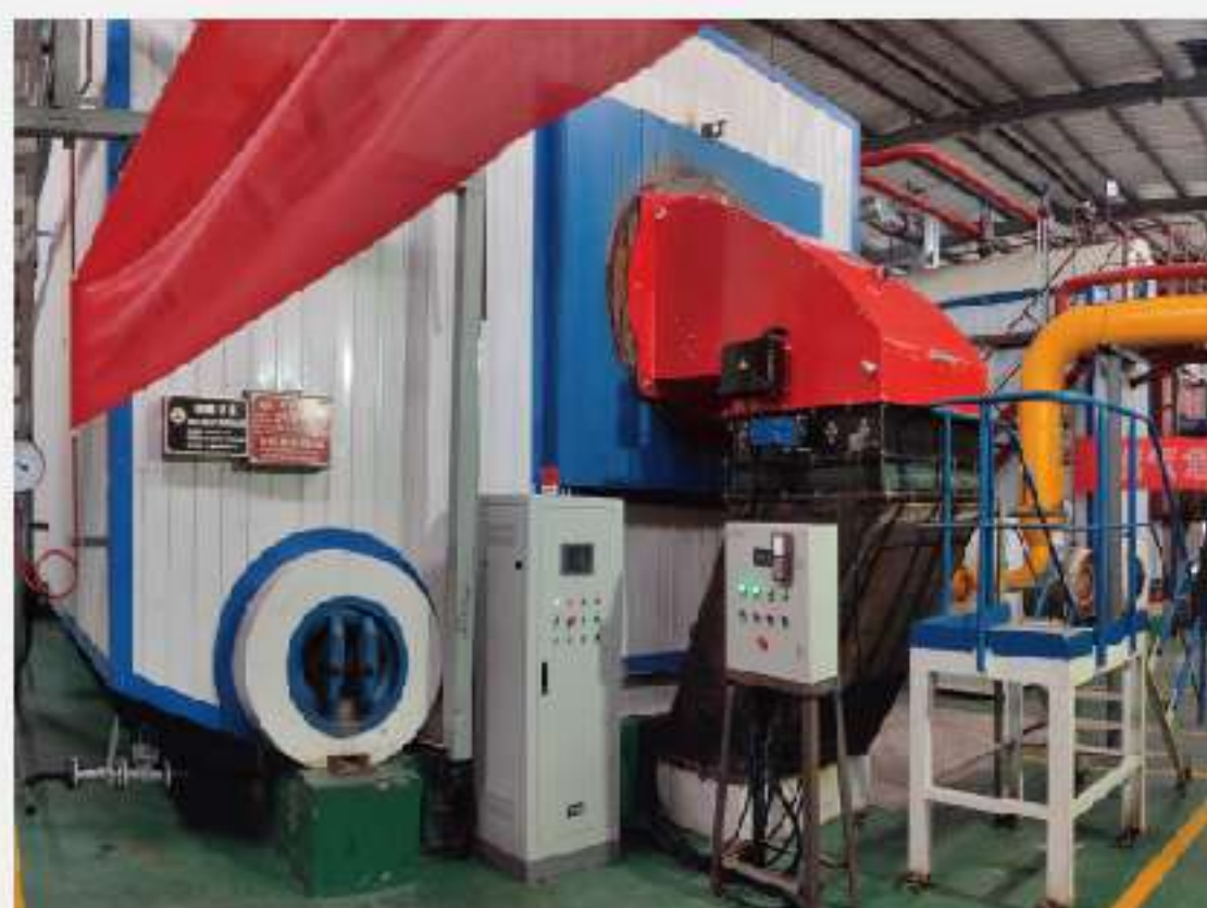
陕西金房能源科技有限公司 40吨热水锅炉 分体式燃烧器内循环 50 mg/m 3
