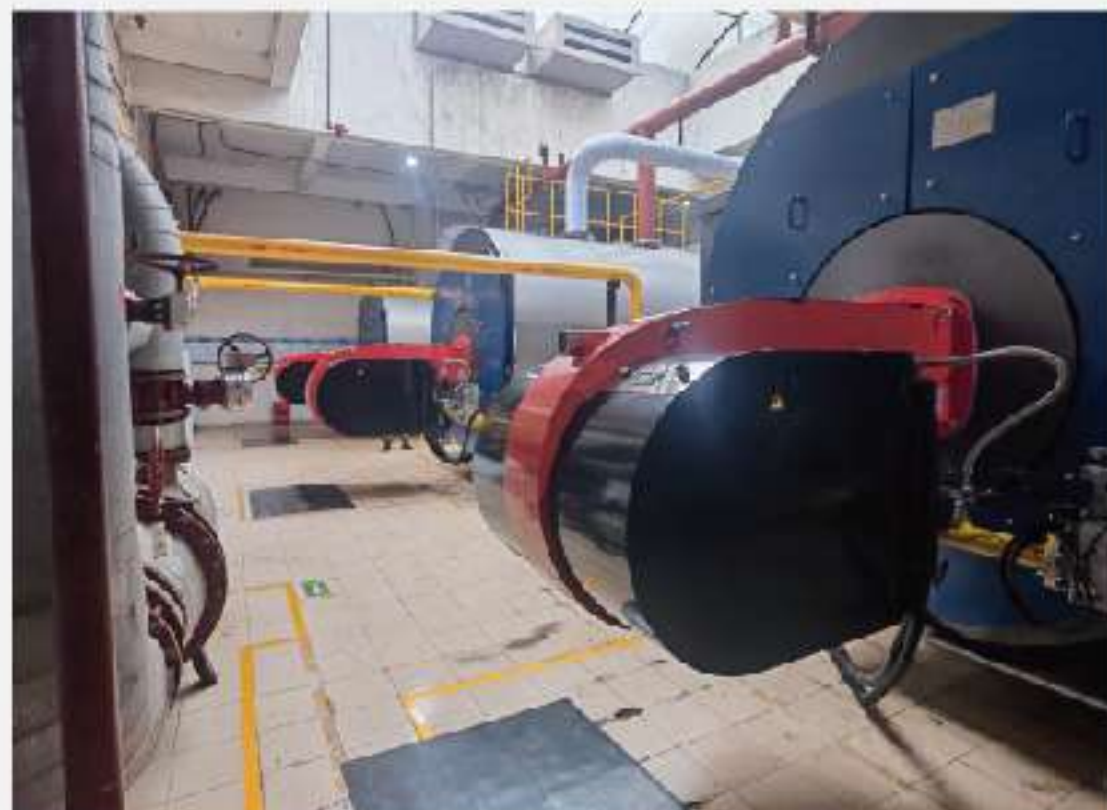
北京珠江中骏小区锅炉房 10吨 热水锅炉 一体式内循环燃烧器 30 mg/m 3
