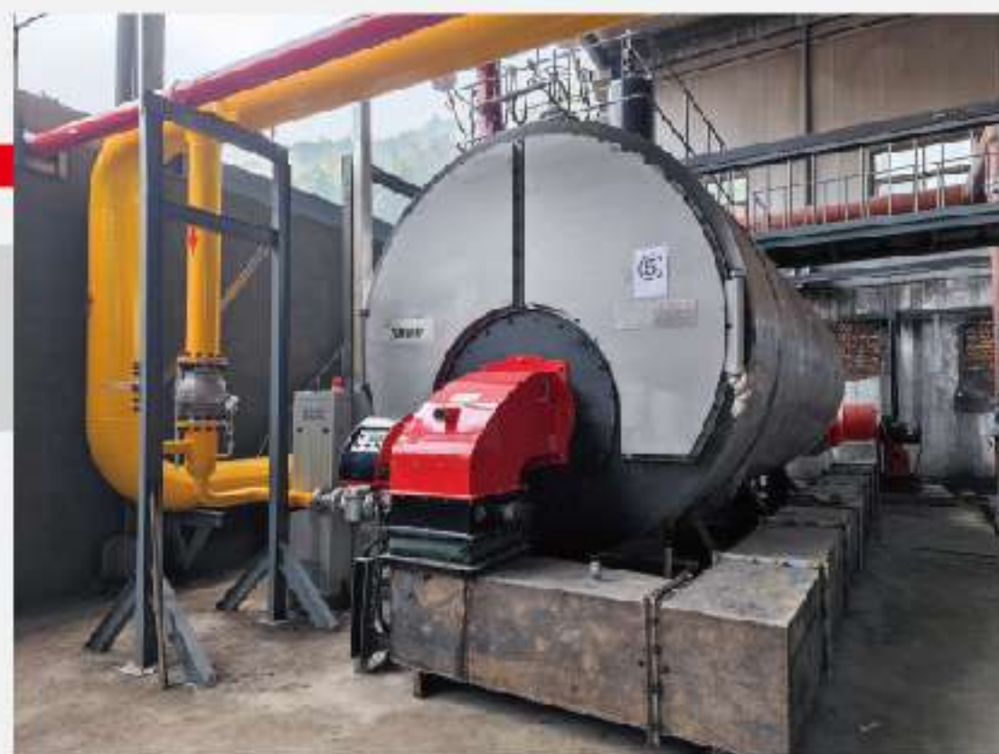
宜川金房热力公司 15吨热水锅炉 分体式内循环低氮燃烧器50 mg/m 3
